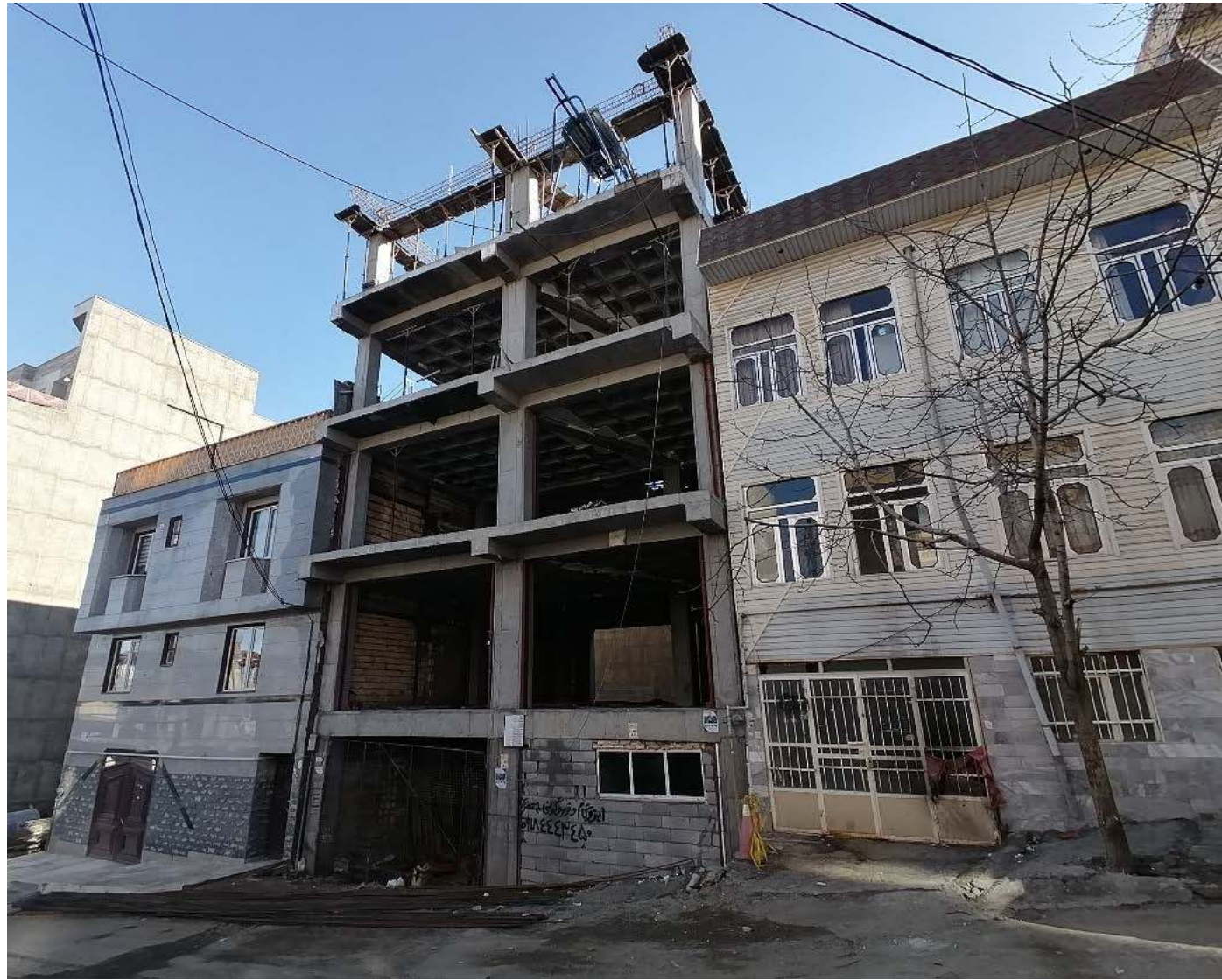
۵- تصاویر وضعیت فعلی بنا. مرحله ساختمانی: مراحل پایانی سفت کاری شماره پرونده: منطقه: ۳
